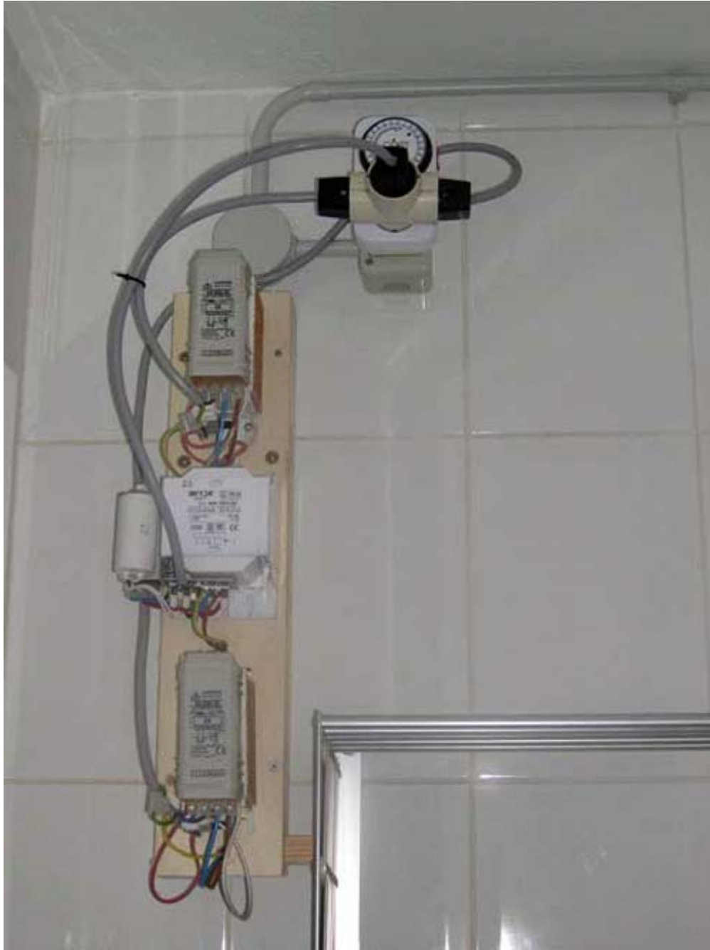
Toma de corriente de los arrancadores para los HQI.
