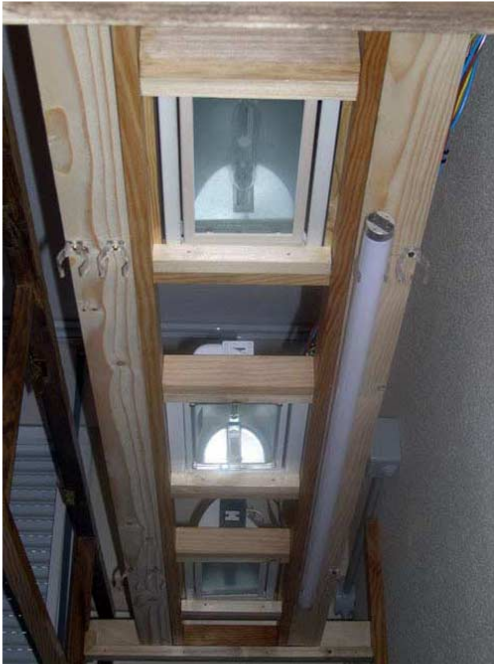
Aspecto de la luminaria.
