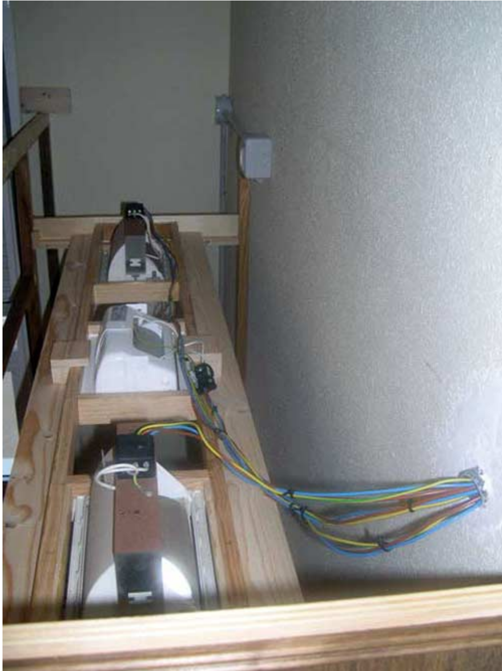
Aspecto de la luminaria.
